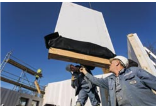
Die perfekt maßgenaue Vorfertigung im Werk erlaubt die schnelle und reibungslose Montage auf der Baustelle.
